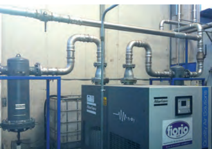
Fig. 8 - Instalações de ar comprimido
