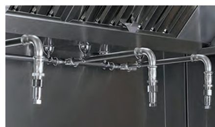
Fig. 10 - Extinção na cozinha
