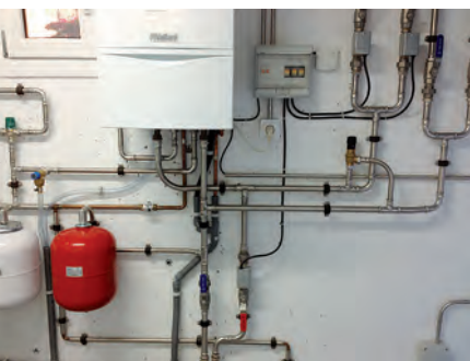
Fig. 5 - Instalações de água quente sanitária
