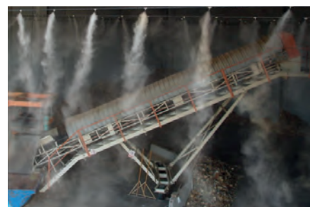
Fig. 12 - Instalações de nebulização
