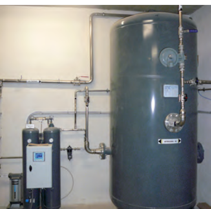
Fig. 7 - Instalações de gás inerte
