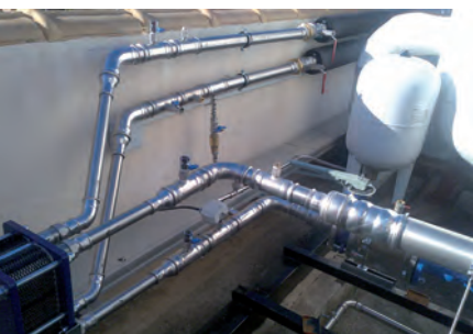
Fig. 6 - Instalações de ar condicionado
